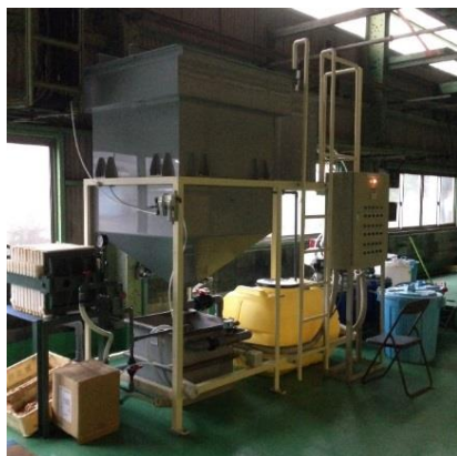
錫回収装置外観
