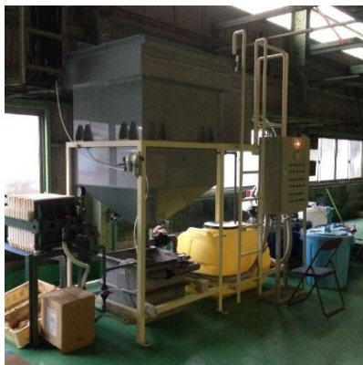
錫回収装置外観
